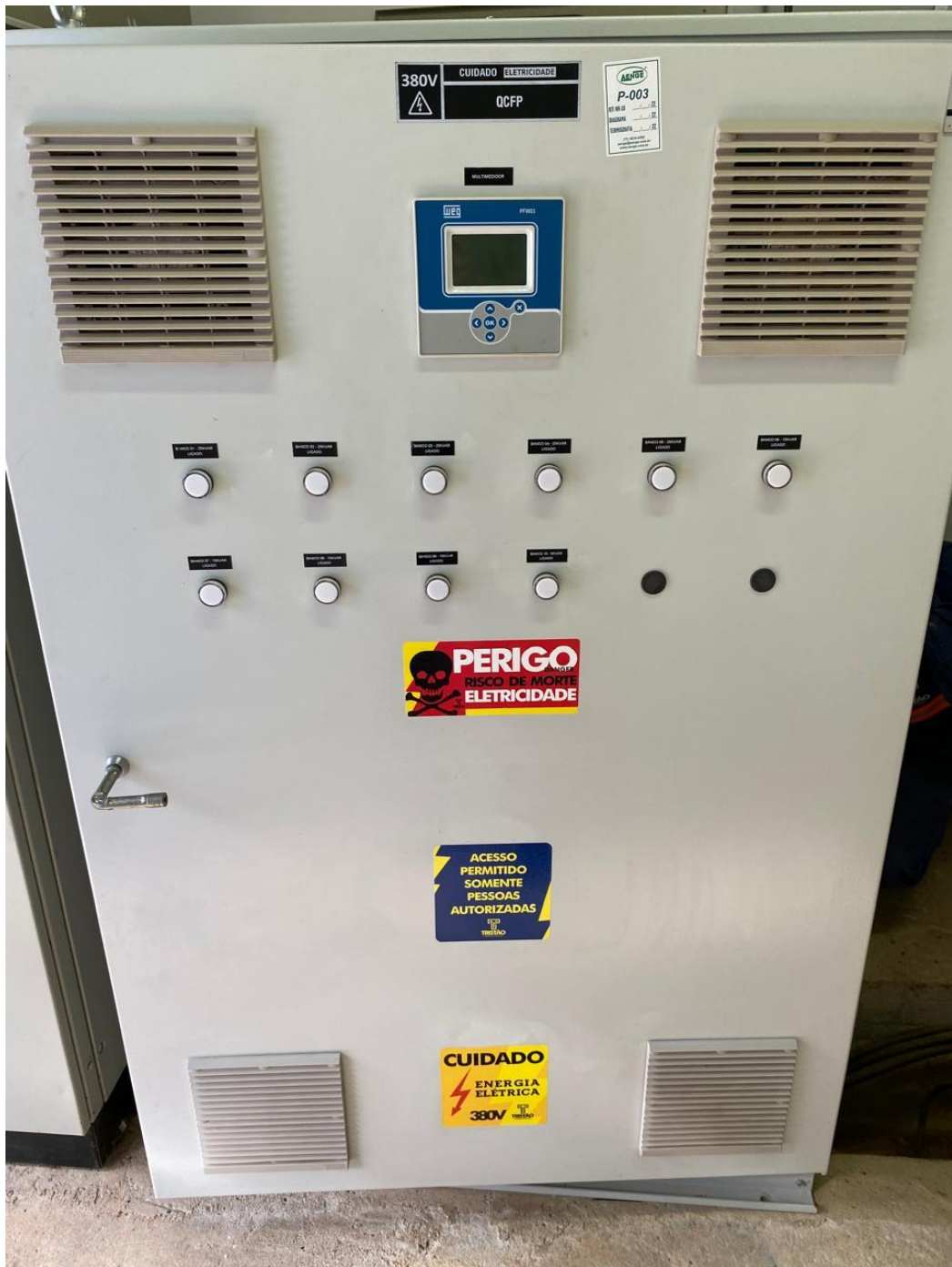
FIGURA 22 - Painel elétrico com o banco de capacitores
