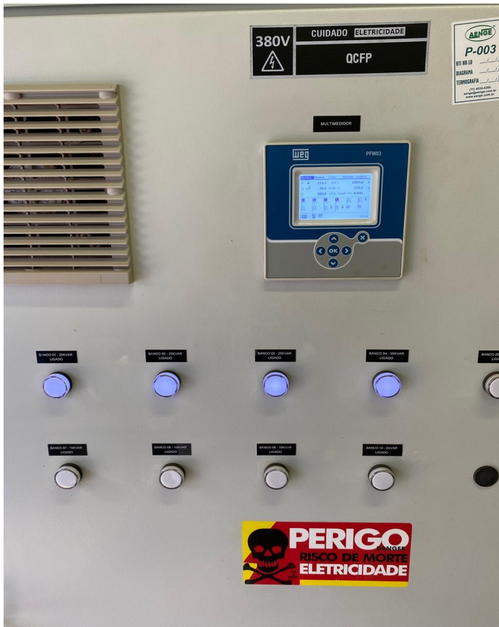
FIGURA 24 - Painel elétrico com o banco de capacitores
