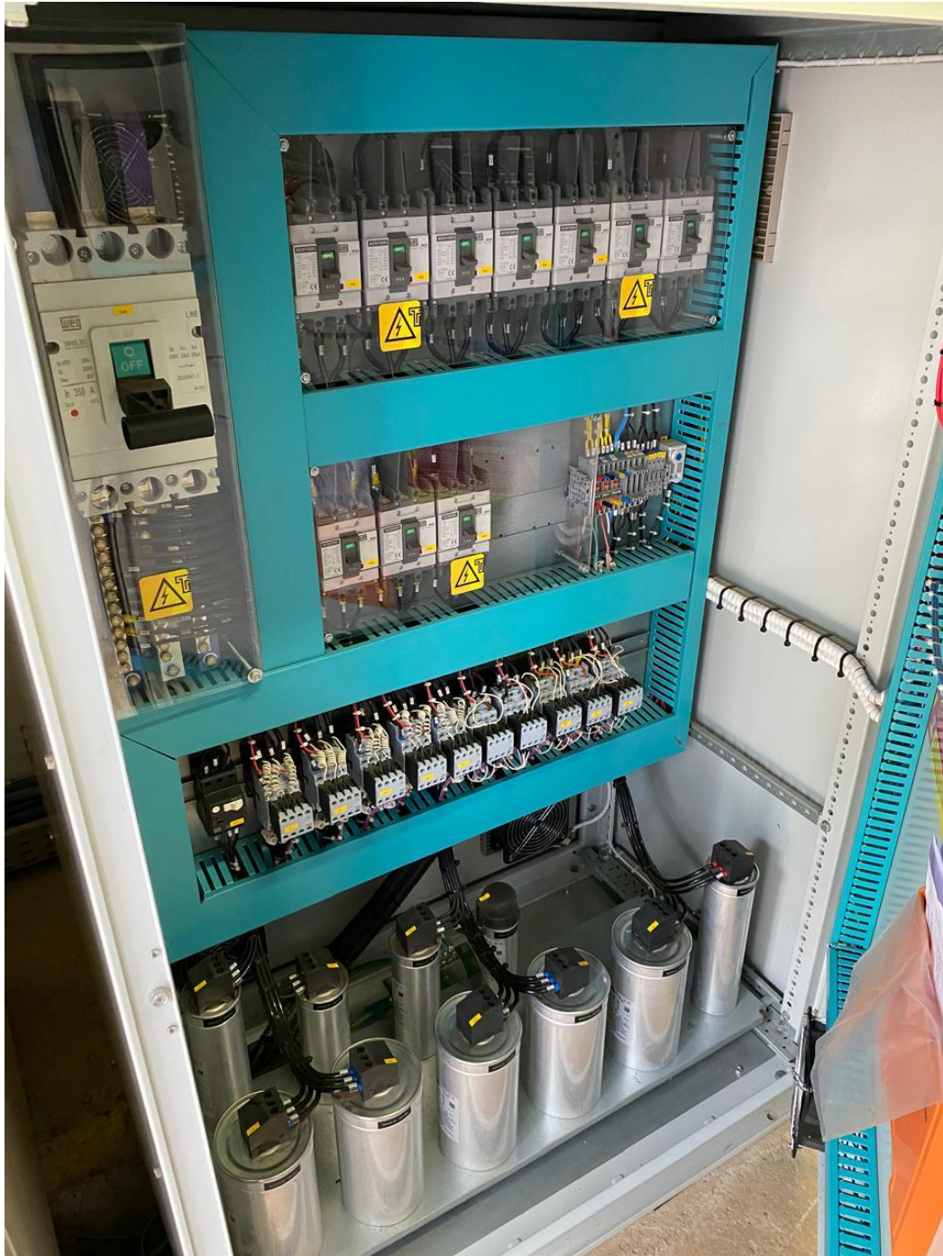
FIGURA 23 - Painel elétrico com o banco de capacitores
