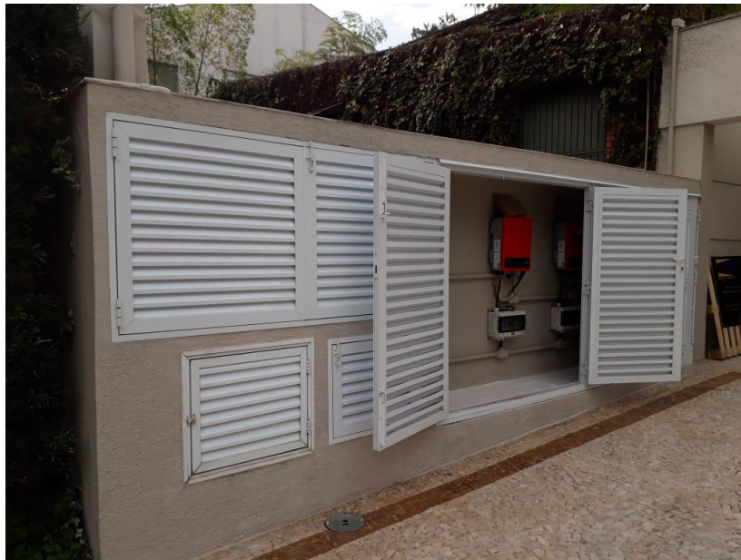
FIGURA 12: Abrigo para Inversor e Baterias
