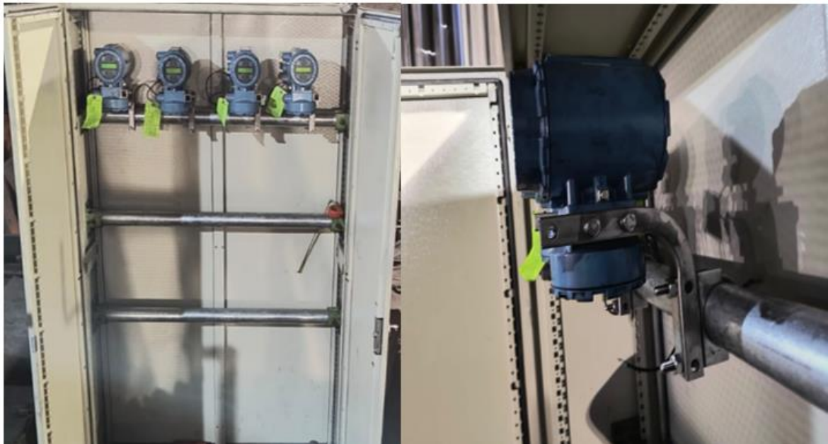
FIGURA 24 – Detalhamento da disposição dos transmissores para medição da vazão no alocados no painel
