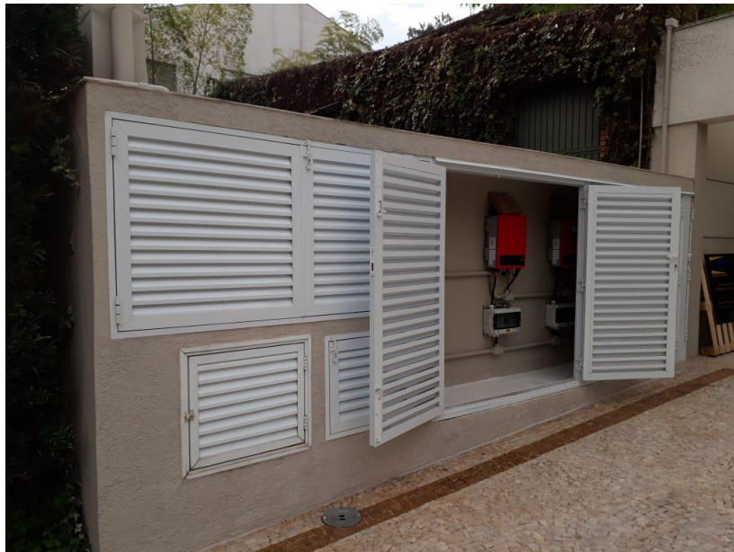
FIGURA 12: Abrigo para Inversor e Baterias
