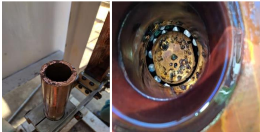
Figura 19 – Contatos do disjuntor com faces irregulares
