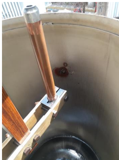
Figura 16 – Falta a terra pela baixa rigidez dielétrica do óleo isolante
