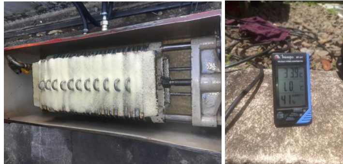
Figura 21 – Filtragem do óleo isolante através do filtro prensa
