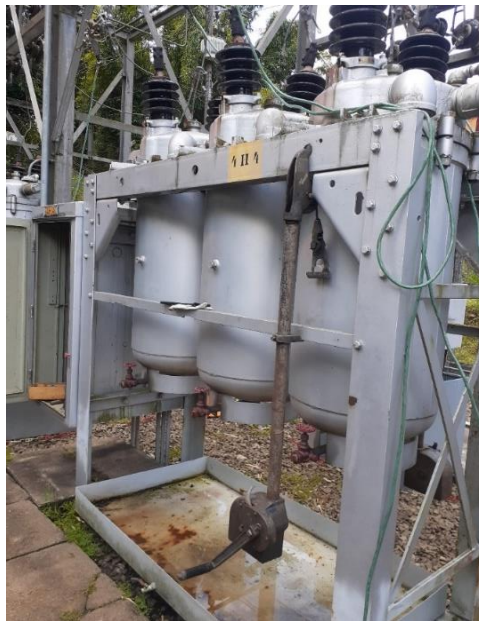
Figura 1 – Disjuntor FK 449 General Eletric GVO
