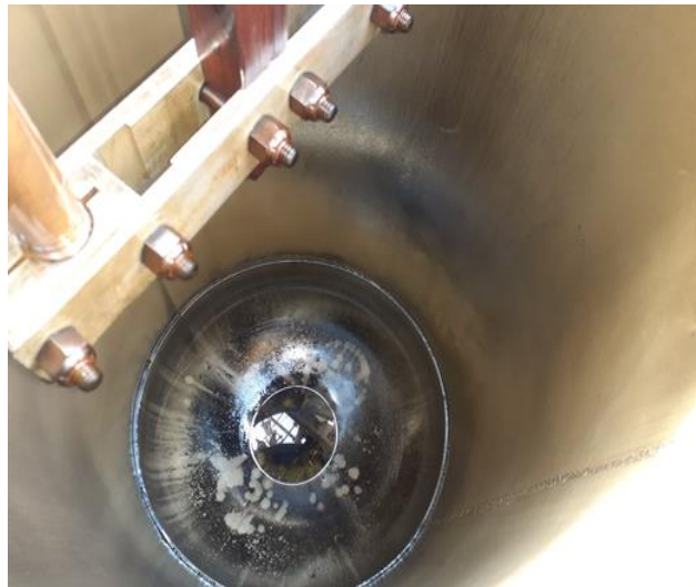
Figura 18 – Interior da cuba do disjuntor
