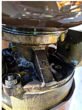
Figura 20 – Acúmulo de óleo sujo no interior do disjuntor
