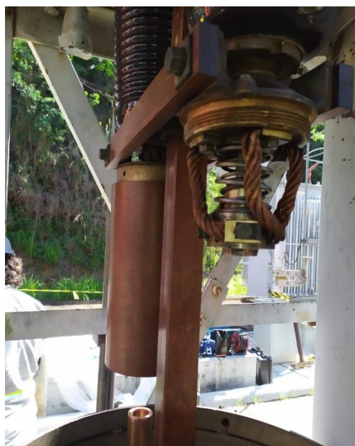
Figura 26 – Interior do disjuntor demonstrando a reinstalação da câmara de extinção de arco
