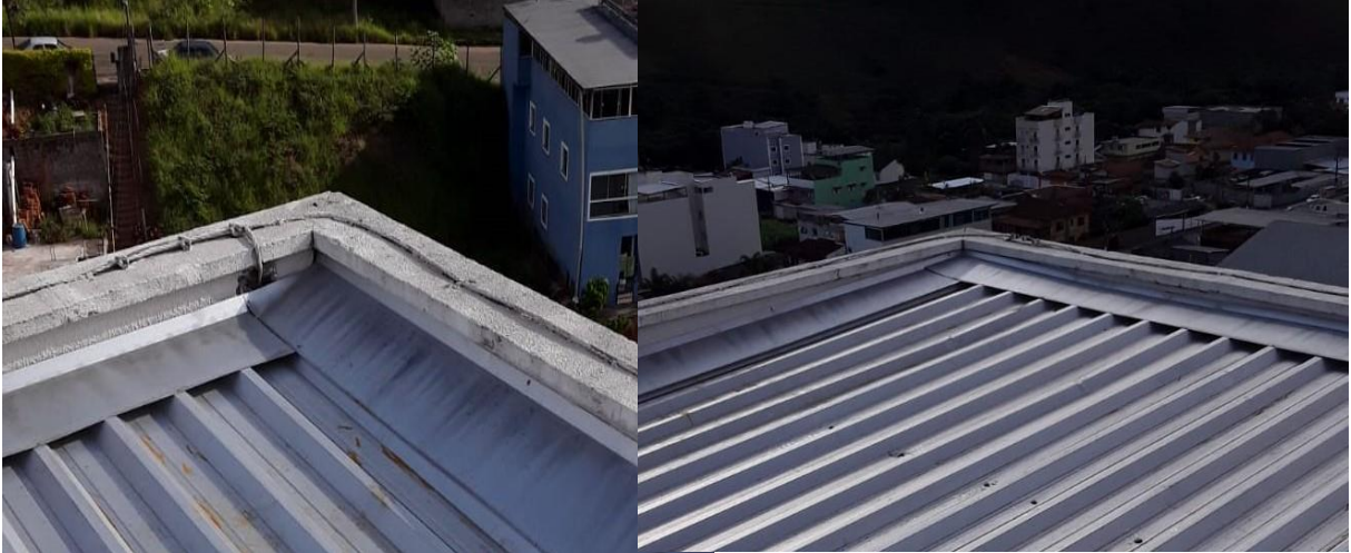
Figura 20 – Falta de minicaptadores e cordoalha entrando na edificação.
