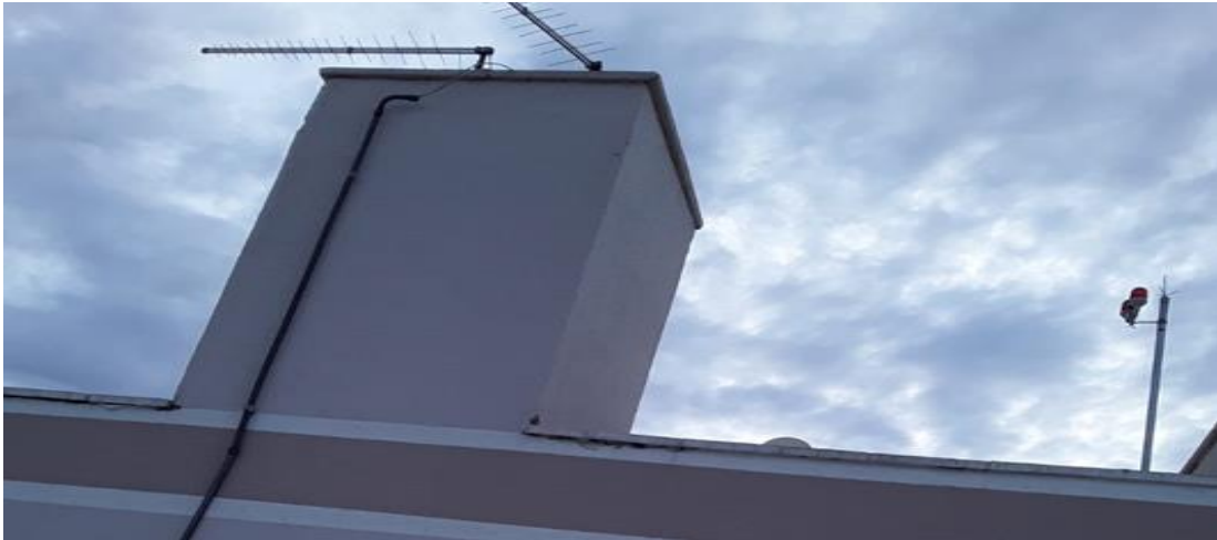
Figura 23 – Captor Franklin com altura menos que o topo da edificação.
