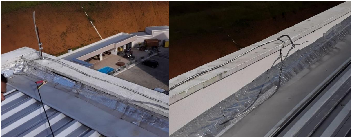
Figura 22 – Cordoalha rompida em 2 torres.
