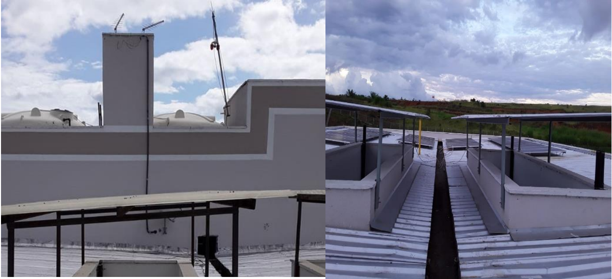
Figura 24 – Estruturas e objetos metálicos não conectados ao SPDA.
