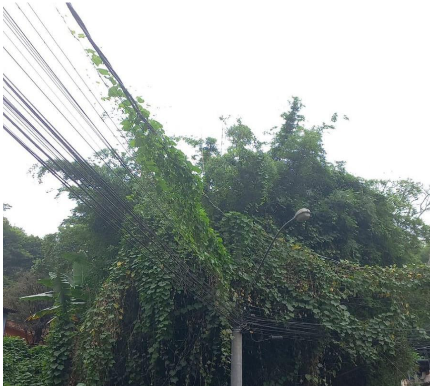
Figura 8 – Rede isolada aérea em local arborizado.
