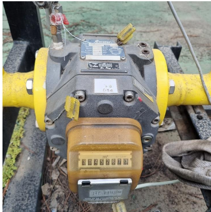
Figura 7 – Medidor tipo rotativo instalado no conjunto de medição
