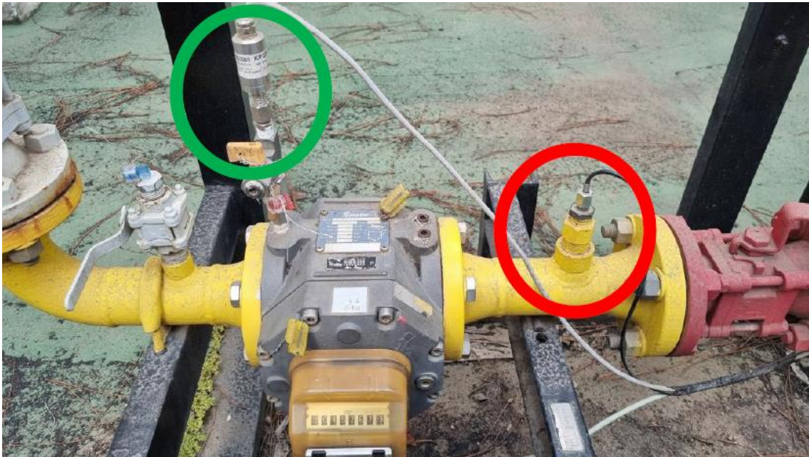
Figura 10 – Sensor de temperatura e transdutor de pressão instalados no conjunto de medição
