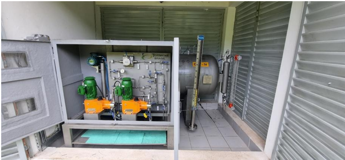
Figura 1 – Foto do sistema de odoração da estação de recebimento de gás natural Chapéu D’uvas.
