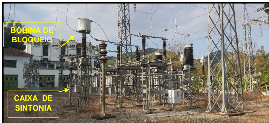
Figura 14 – Acopladores Carrier de uma LT de 138KV
