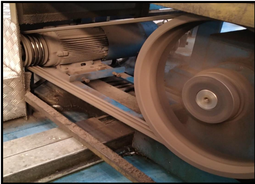
Figura 19 – Fixação motor trifásico 15 cavalos
