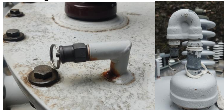
Figura 30 – Válvulas de Alívio de Pressão.
