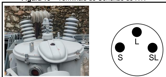
Figura 15 – Terminais de Conexão do RT.
