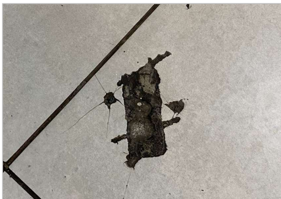
FIGURA 4: Piso com rachaduras que comprometem o bom estado de conservação.
