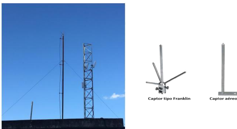
Figura 5: Pára-raio tipo Franklin instalado no CES Academia
