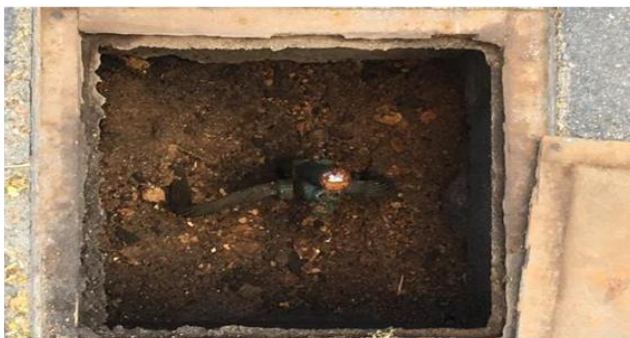
Figura 7: Subsistema de aterramento instalado no CES Academia
